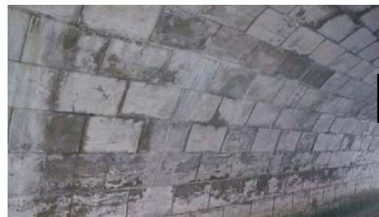
写真2. 上：改築前の榎瀬川樋門 (大正時代の構造、2010撮影) 下：改築前の榎瀬川樋門の内部 (コンクリートブロック、2010撮影)
