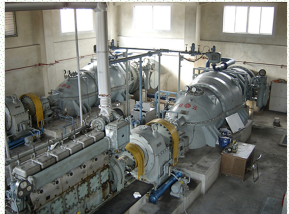
写真4. 川島排水機場 ポンプ設備 (昭和39年)
