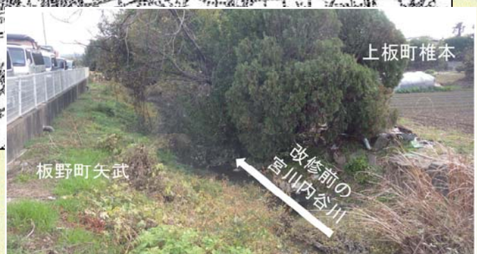
写真4 改修前の宮川内谷川 (板野町矢武と上板町椎本の境)
