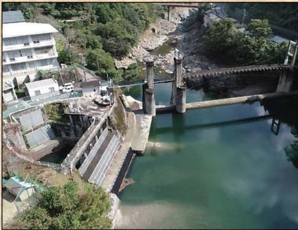
写真 3 取水用堰堤（伊予川発電所上流） 提供： 四国電力株式会社 徳島支店 技術部 池田水力センター
