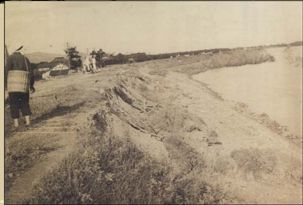
写真 3 堤防決壊寸前の吉野川 (昭和 29 年 9 月ジューン台風)
