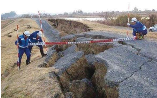
写真1.東日本大震災で破損した堤防 出典：東北地方整備局
