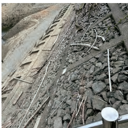
法面には泥が固着し、流木が散乱
