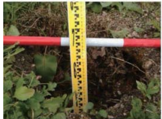
写真4.堤防で発見された穴
