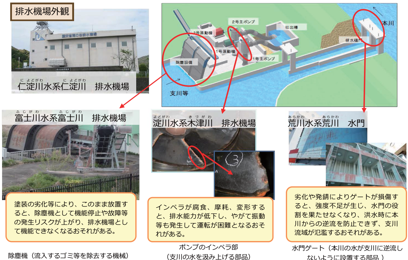
図2.機械設備における老朽化の事例
