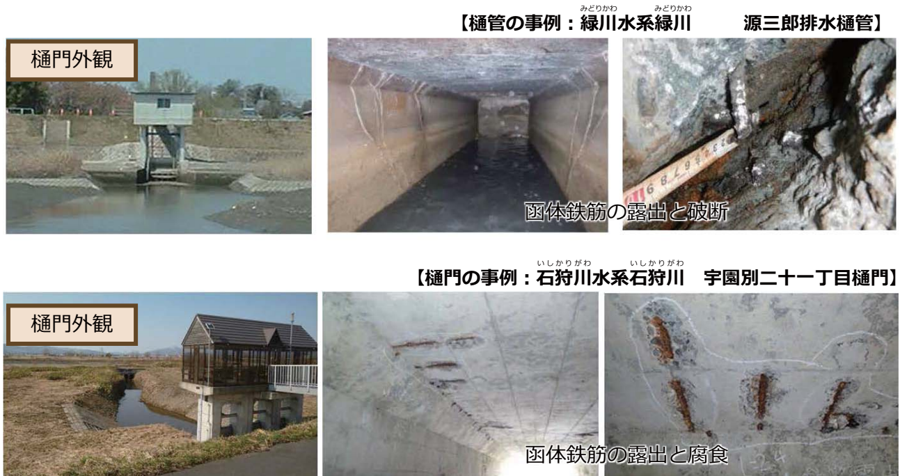
写真4.土木構造物内におけるコンクリートの劣化の事例
