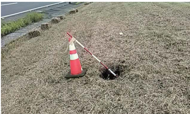
おっ、堤防の陥没を発見！
