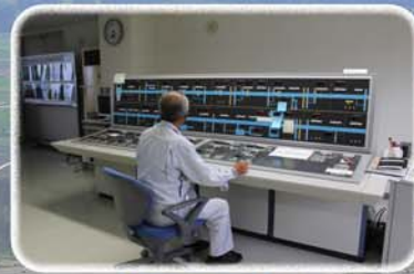
中央管理システム 遠隔操作でゲートを動かし、幹線水路の水量調整を行っている。
