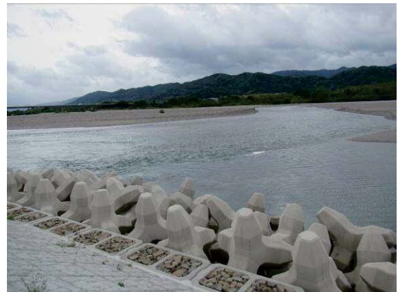
写真-4 水衝・洗掘
