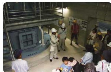
ポンプ室内。毎秒排出できる20トンの水は、ドラム缶100本分に相当する
