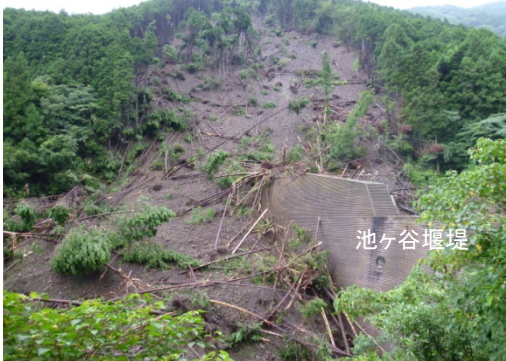
崩壊状況(H27.7.18撮影)
