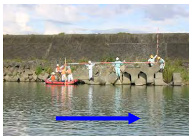
台風14号 吉原箇所 水制崩落状況
