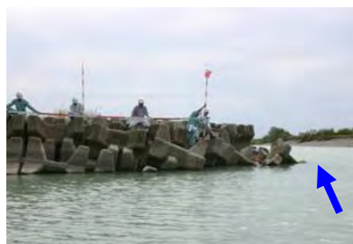
台風14号 吉原箇所 水制崩落状況
