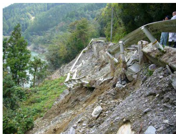
大川村小南川県道の被災（平成17年）
