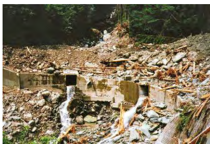
大川村鈴ヶ谷 県道の被災 （平成16年）
