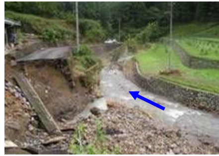
葛川（松野町）の被害状況（H16 台風 10 号） 増水により護岸が崩壊
