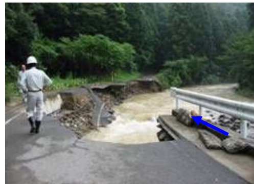
保場川（宇和島市）の状況（H16 台風 10 号） 増水により護岸が崩壊
