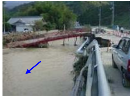
阿島川（新居浜市）の被害状況（H16台風21号） 流木により橋梁箇所が閉塞し、橋梁が崩落
