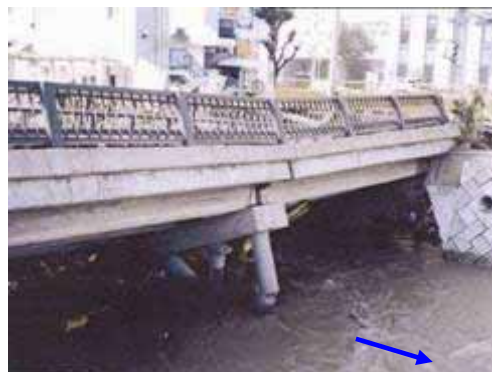
尻無川（新居浜市）の橋梁被害（台風21号） 流木により橋梁箇所が閉塞し、庄内橋（市道橋）が崩落
