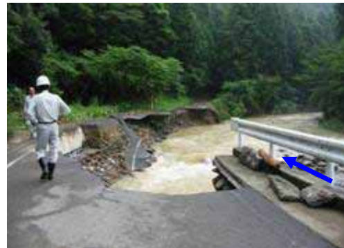
保場川(宇和島市)の状況(H16台風10号) 増水により護岸が崩壊
