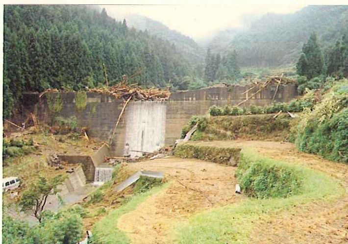
土石流を補足した成谷川えん堤 H11.9(愛媛県東温市)
