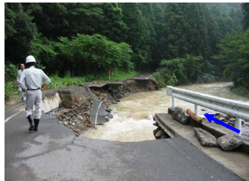
保場川（宇和島市）の状況（H16 台風 10 号） 増水により護岸が崩壊
