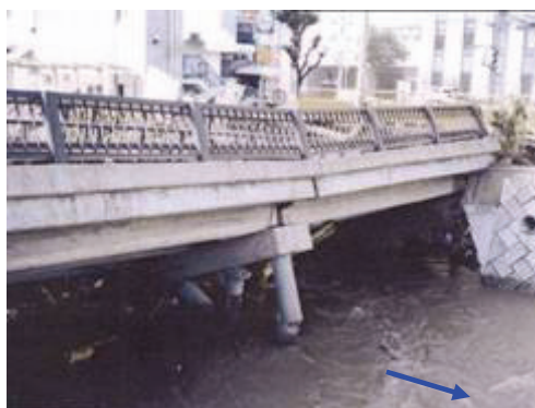
尻無川（新居浜市）の橋梁被害（台風21号） 流木により橋梁箇所が閉塞し、庄内橋（市道橋）が崩落
