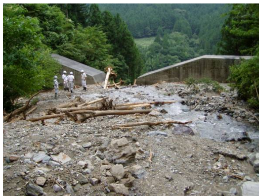
H16年台風16号・23号により土石流が発生 （上浮穴郡久万高原町） （写真は台風16号後、既設えん堤により土石流捕捉）
