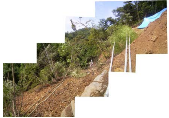
宇和島市高串の山腹崩壊（H18 7 月梅雨前線豪雨）
