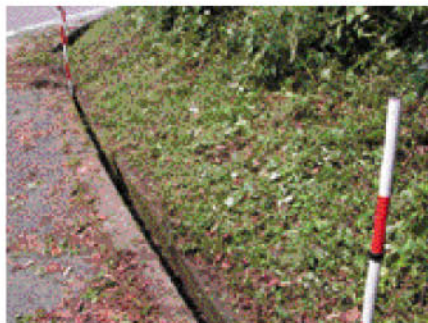
【井尻地区】 土塊の押出しにより水路閉塞
