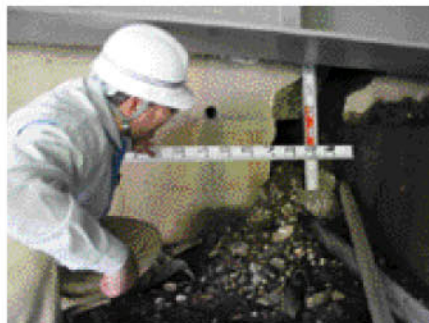
【下中切地区】 大川橋橋台にクラック発生
