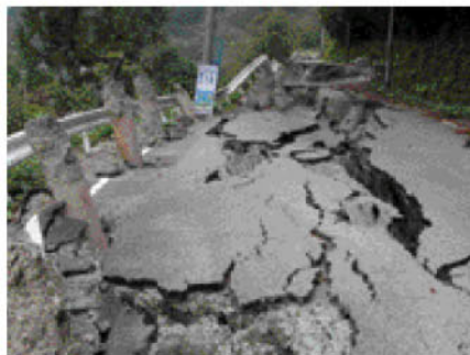
【小南川地区】 変状により県道崩壊
