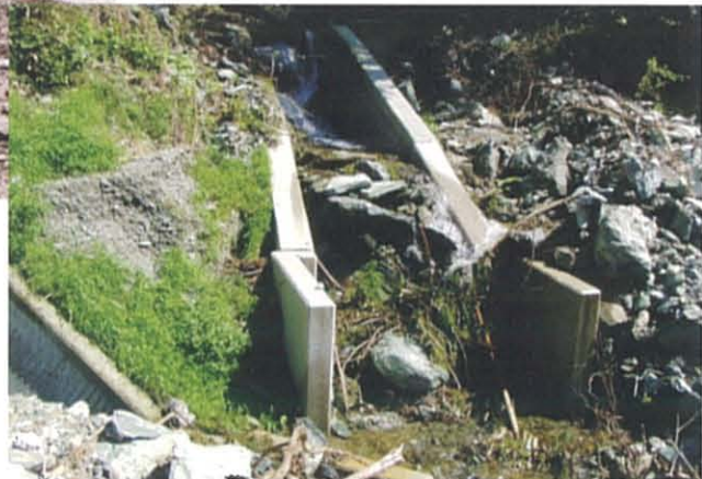
水路沿の溪崖侵食→
