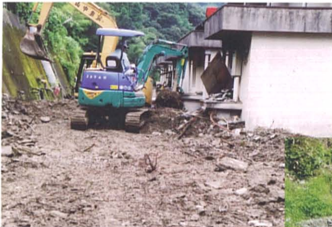
←村営小松団地の被災状況
