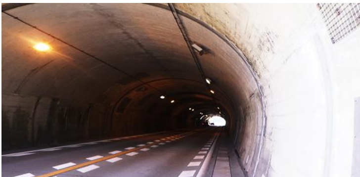
トンネル照明のLED化：高知県黒潮町 国道56号 伊田トンネル
