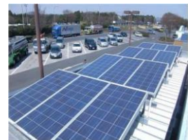
太陽光発電施設
