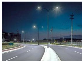
LED道路照明 (消費電力約56%削減)
