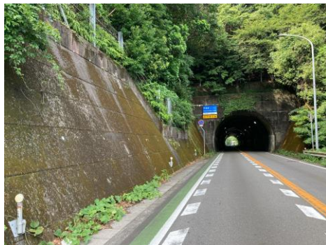
注意喚起看板：高知県東洋町 国道55号
