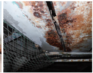
縦桁の腐食(横断歩道橋)
