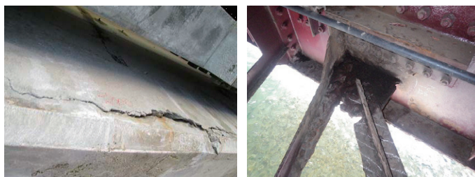
老朽化により損傷の著しい橋梁(例)
