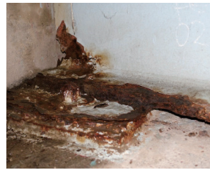
主桁の腐食(橋梁)
