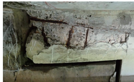
主桁の剥離・鉄筋露出（例）
