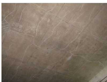
【ひび割れ(点検時)】
