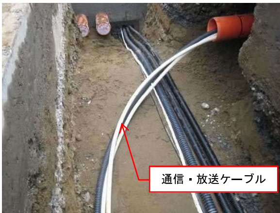
通信・放送ケーブルの引込状況
