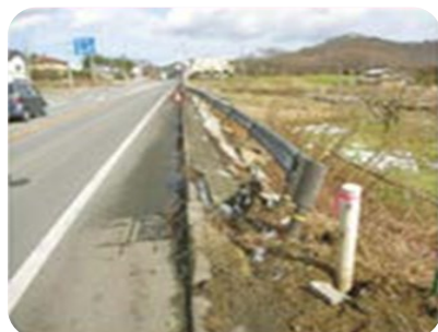
ガードレール・ 標識等の損傷
