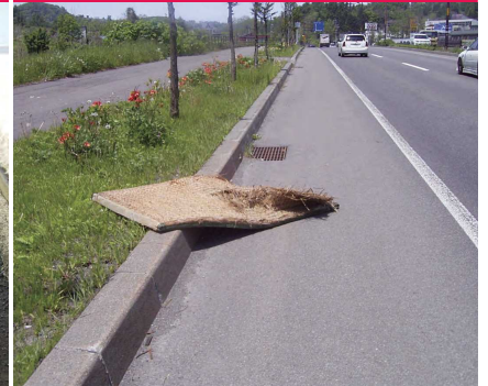
路面の落下物
