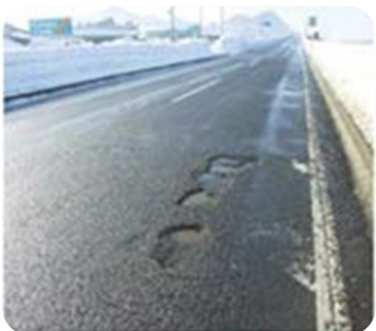
路面の穴ぼこ・ 段差
