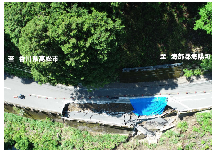
被災後の状況 (全景)
