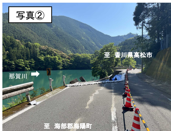
被災後の状況 (終点側)
