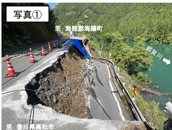
被災後の状況 (起点側)
