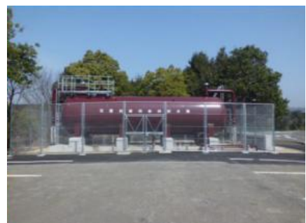
災害に備えた飲料貯水槽
