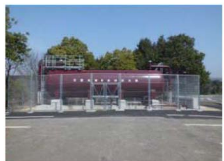
災害に備えた飲料貯水槽
