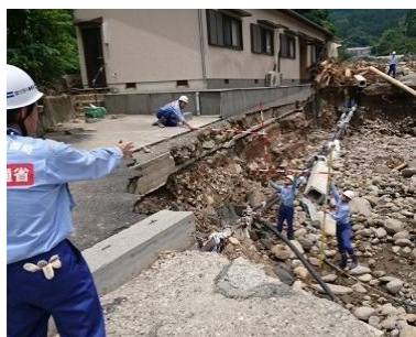
河川被害状況の調査
