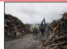
【道路啓開状況】
