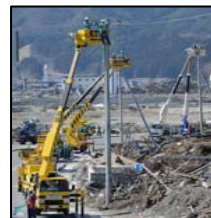
【ライフライン復旧状況】 毎日新聞HPより
