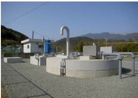
簡易水源施設(管理者:大洲市)
