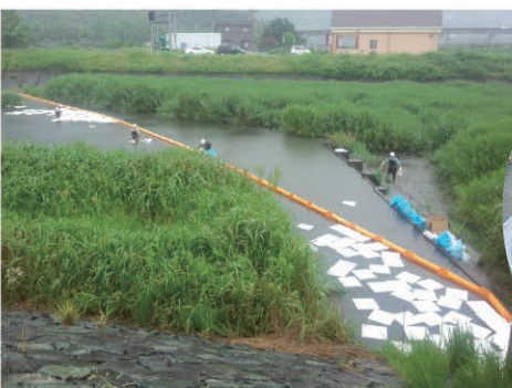
油等流出事故対策状況
