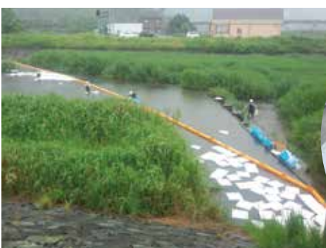
油等流出事故対策状況
