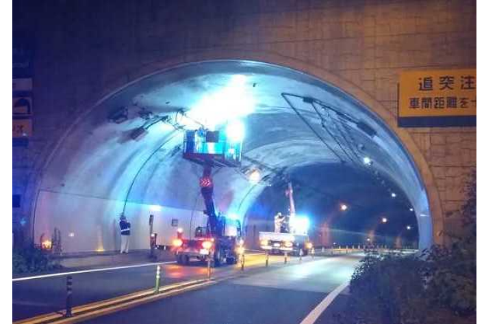
トンネル照明LED化等
