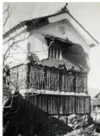
昭和20年9月(枕崎台風) 壁の落ちているところまで浸水したという 大洲市若宮地先の家屋
