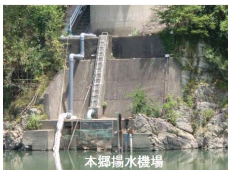
図 2.5 本郷揚水機場の様子
