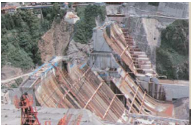
本体コンクリート打設開始（昭和51年6月）（右岸側よりダムを望む）
