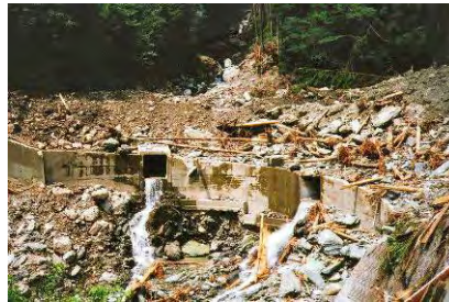
大川村鈴ヶ谷 県道の被災 （平成16年）
