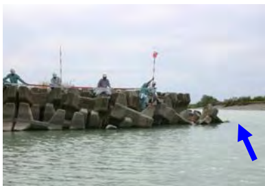
台風14号 吉原箇所 水制崩落状況
