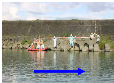
台風14号 吉原箇所 水制崩落状況
