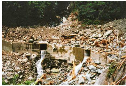
大川村鈴ヶ谷 県道の被災 （平成16年）
