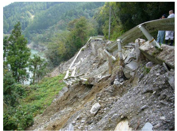
大川村小南川県道の被災（平成17年）
