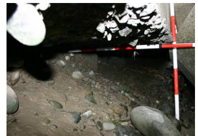
台風14号 吉原箇所 洗掘状況
