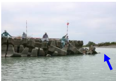
台風14号 吉原箇所 水制崩落状況
