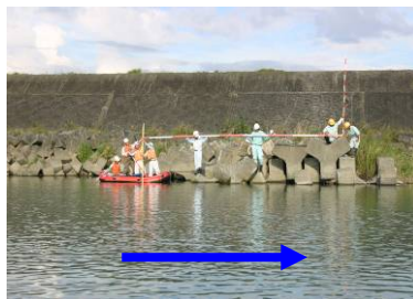
台風14号 吉原箇所 水制崩落状況
