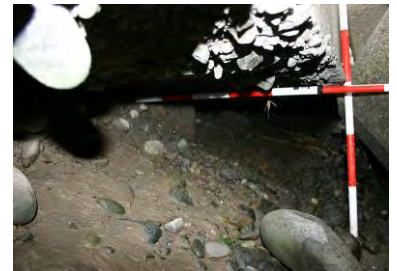
台風14号 吉原箇所 洗掘状況
