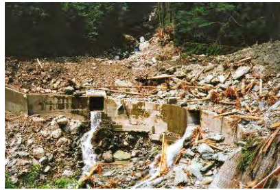
大川村鈴ヶ谷 県道の被災 (平成16年)
