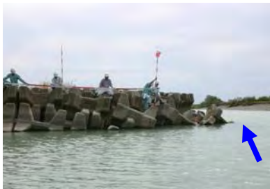
台風14号 吉原箇所 水制崩落状況
