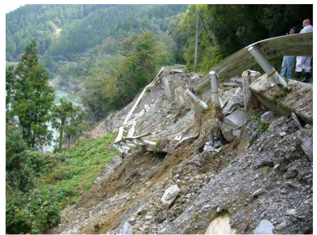
大川村小南川県道の被災(平成17年)
