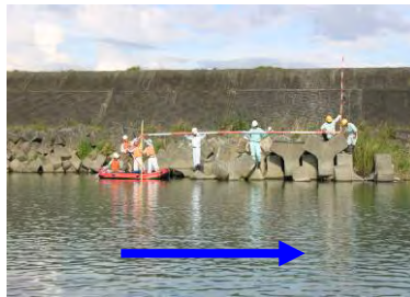
台風14号 吉原箇所 水制崩落状況
