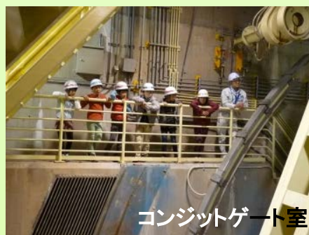
コンジットゲート 操作室
