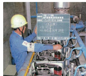
専門技術者による機械設備点検
