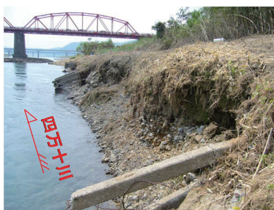
護岸の被災状況
