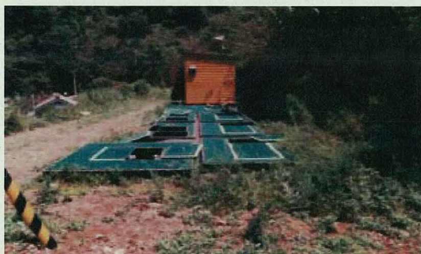
梶原町 事業所排水浄化実験施設
