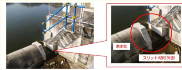
農業用ため池の洪水調節機能を強化するための「洪水吐きスリット」設置状況
