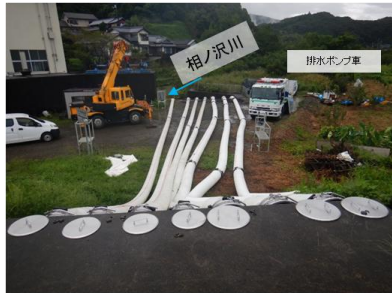
【写真】排水ポンプ車 実排水 ポンプ設置状況 清水樋門 堤外側
