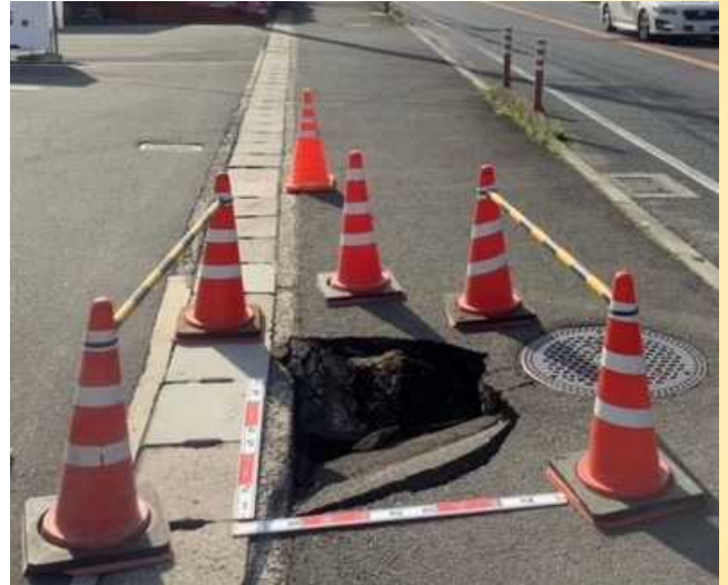
地下埋設物に起因する歩道の陥没
