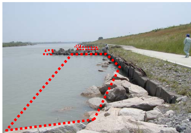
【平成16年5月洪水による深掘れ（洗掘）状況】 （大京原地先：阿南市那賀川町）
