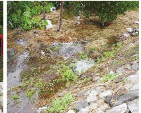
上大野地区 漏水状況写真 (H16台風10号)
